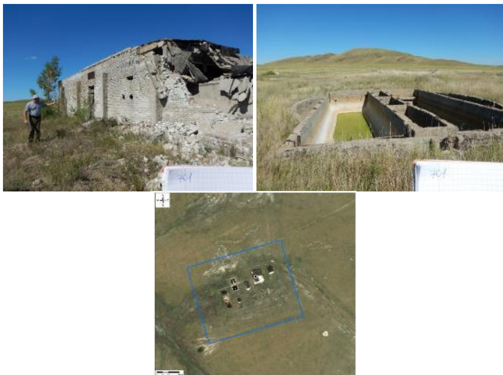
Рисунок 1478 - Объект 701. Очистные сооружения площадки «Г» (Географические координаты: широта 49°53'15,14", долгота 77°56'50,99")
