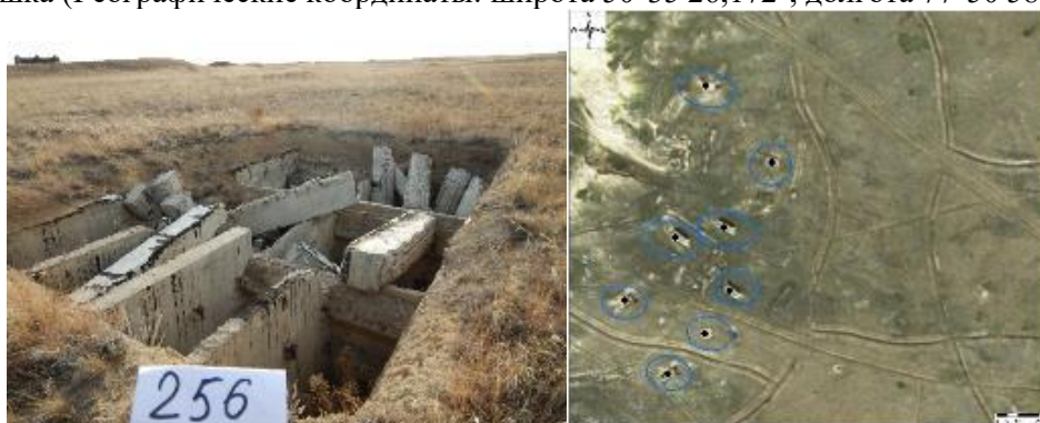
Рисунок 581 - Объект 256 Ж/б подземное сооружение, разрушенное (Географические координаты: широта 50°35'25,585", долгота 77°50'57,328")
