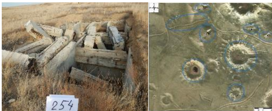
Рисунок 579 - Объект 254 Ж/б подземное сооружение, разрушенное (Географические координаты: широта 50°35'26,734", долгота 77°50'56,365")
