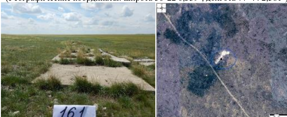
Рисунок 421 - Объект 161 Разрушенный поильник (Географические координаты: широта 50°15'44,419", долгота 78°42'21,74")
