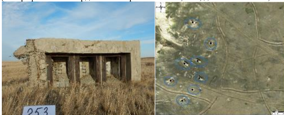
Рисунок 578 - Объект 253 Ж/б сооружение, полуразрушенное (Географические координаты: широта 50°35'26,816", долгота 77°50'58,893")
