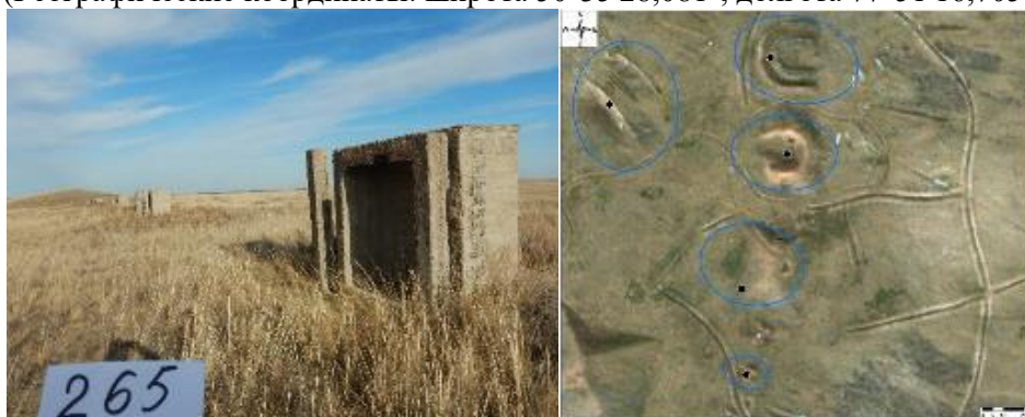
Рисунок 592 - Объект 265. 4 ж/б конструкции (Географические координаты: широта 50°35'24,675", долгота 77°51'15,498")
