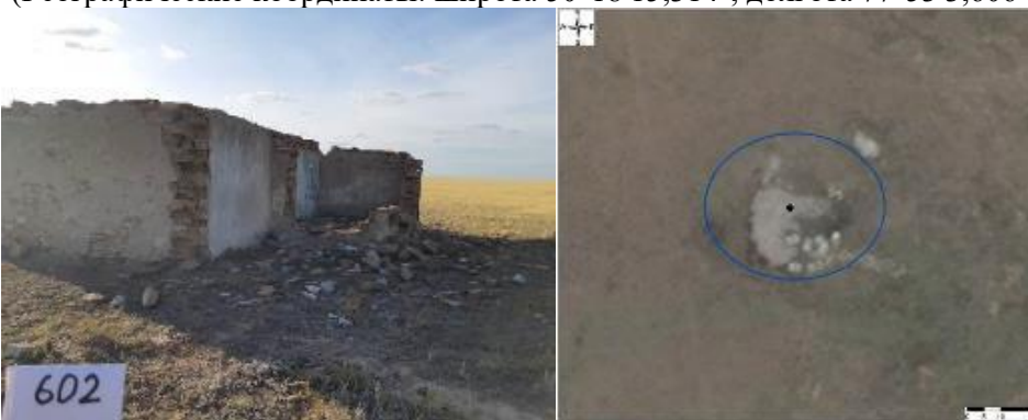
Рисунок 1035 - Объект 602 развалины, бетонные емкости (Географические координаты: широта 50^{\circ}43'47,351'' , долгота 78^{\circ}0'34,611'' )
