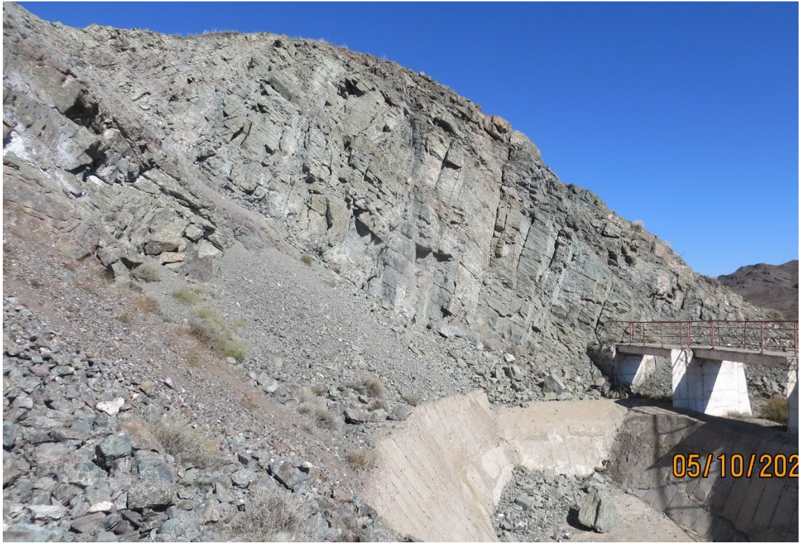
Рис.8.17. Обрушение склона примыкания к ковшу катастрофического водосброса.
