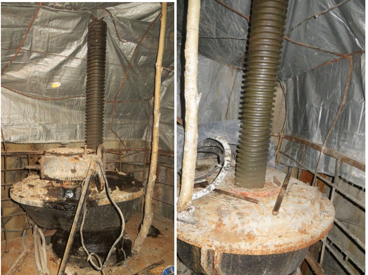
Рис.8.13. Техническое состояние электрического привода затворов. Сплошная коррозия металла.
