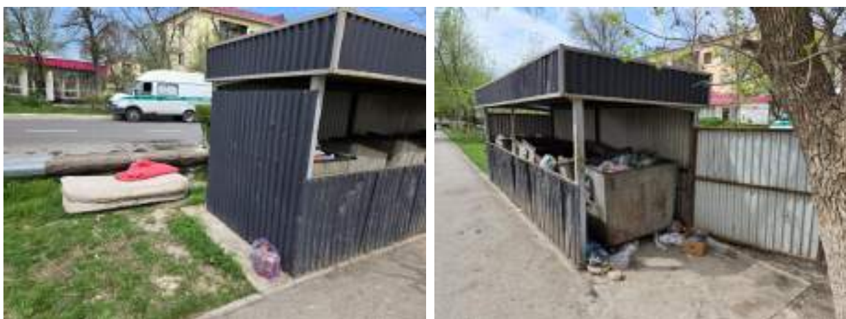
Рисунок 15.17– Состояние контейнерной площадки в г. Кентау (площадка 6)
