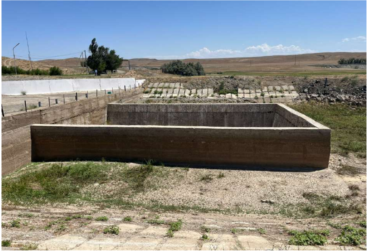
Рис 7.8 ковшовый катастрофический водоприемник в верхнем бьефе. Наблюдается интенсивное крошение бетонного крепления.
