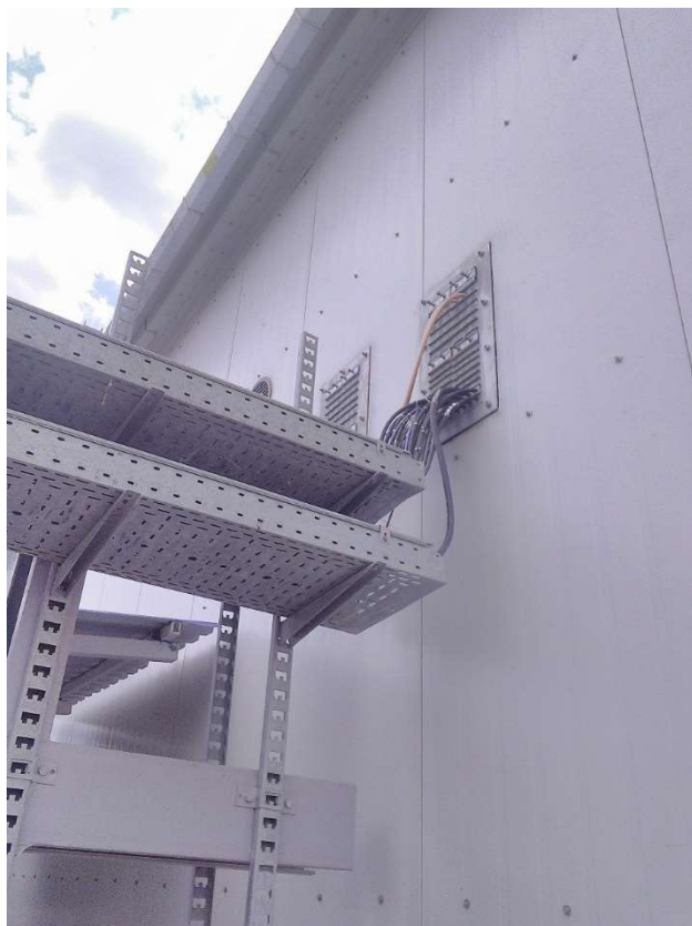
Общий вид кабельного ввода операторной
