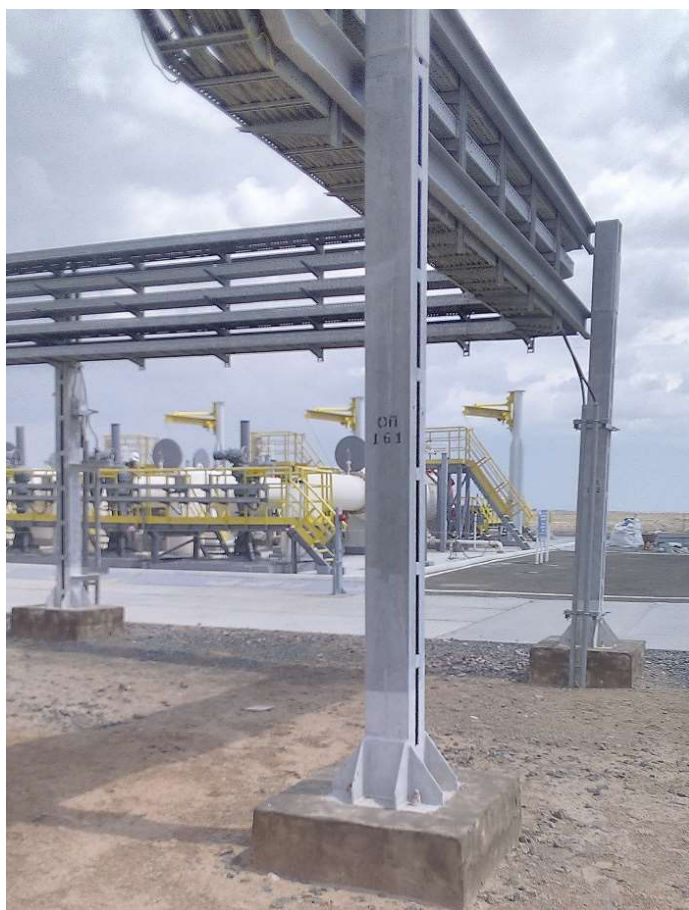
Общий вид опоры кабельной эстакады 161 (нет подведенных кабелей)
