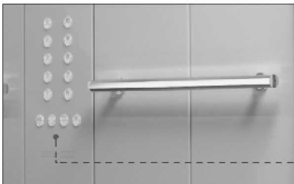
На кнопках лифтов для слепых будут выполнены выпуклости. КНОПКИ С ПОДСВЕТКОЙ И АЗБУКОЙ БРАЙЛЯ
