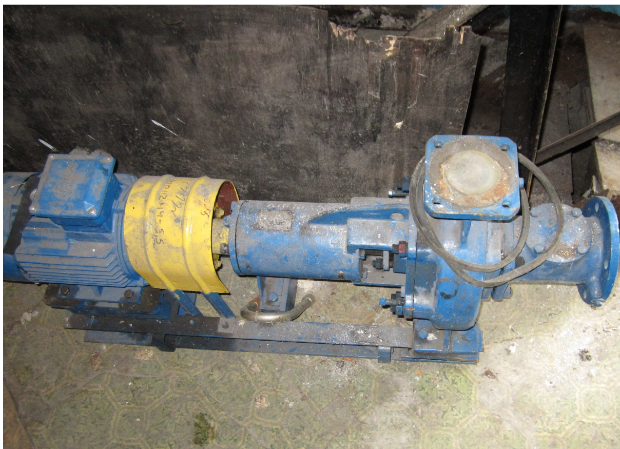
Рисунок 2.4 Насос перекачки хозяйственно бытовых стоков
