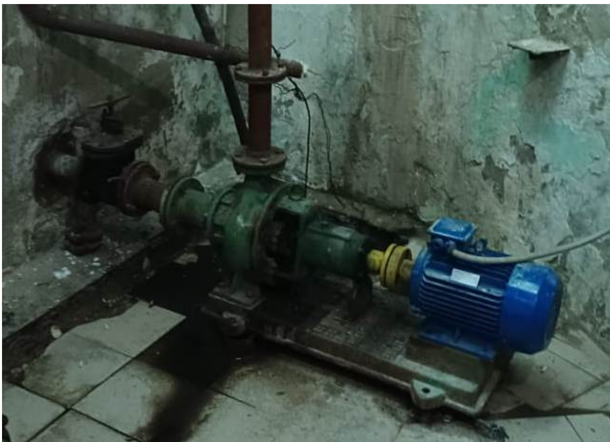
Рисунок 2.9 Перекачивающее оборудование (насосы)
