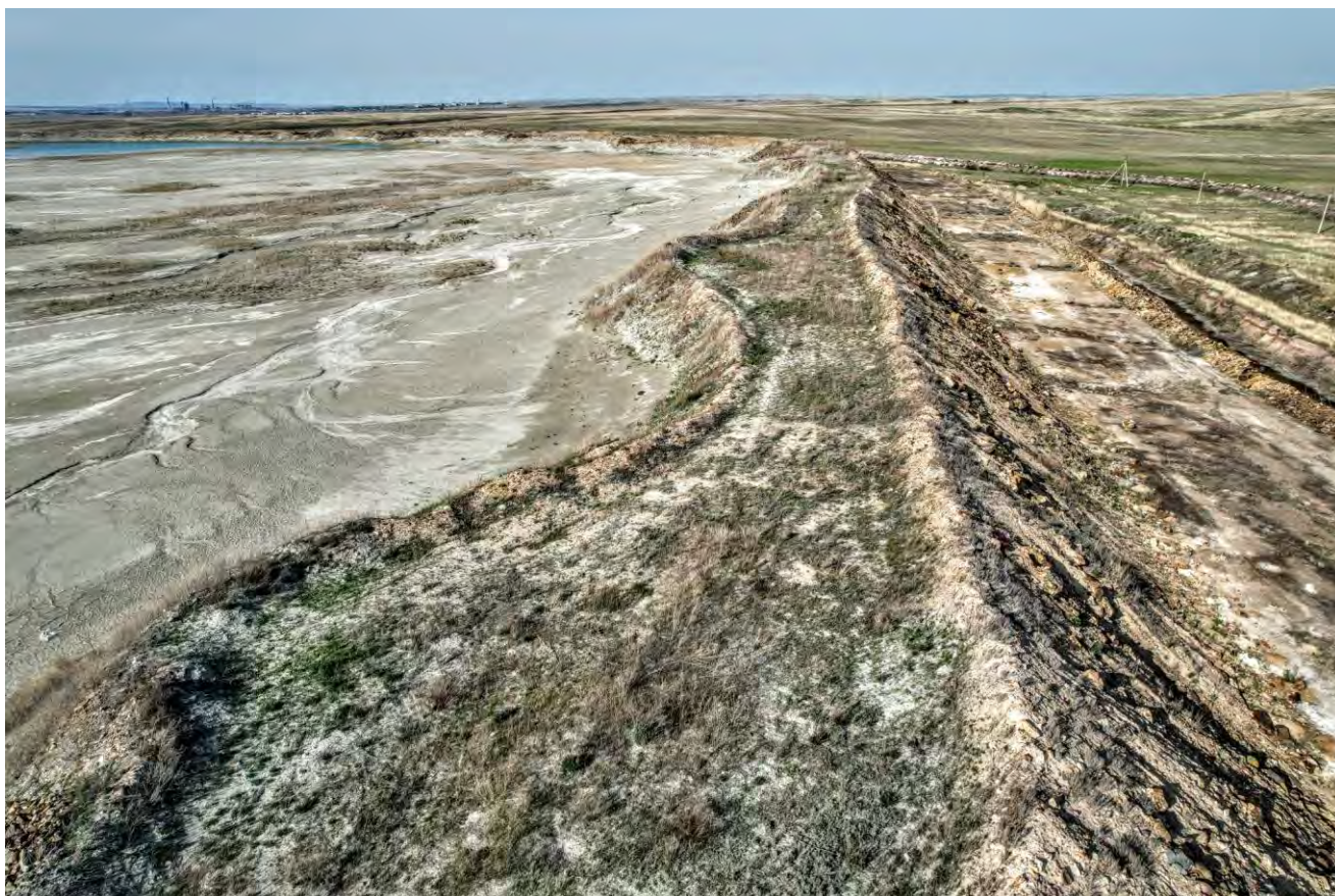
Фото 4.2.4 Самозарастание на гребне ограждающей дамбы
