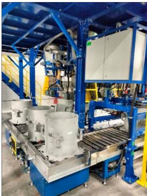
Рисунок 3.8 – Автоматические весы–дозаторы 2 этаж
