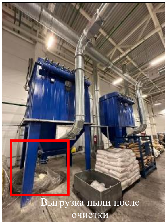
Рисунок 3.7 – Очистное сооружение на ист. 0064–0065 (3 этаж)
