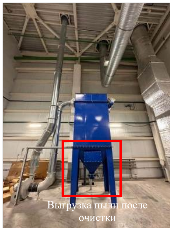
Рисунок 3.11 – Очистное сооружение на ист. 0066 (3 этаж)
