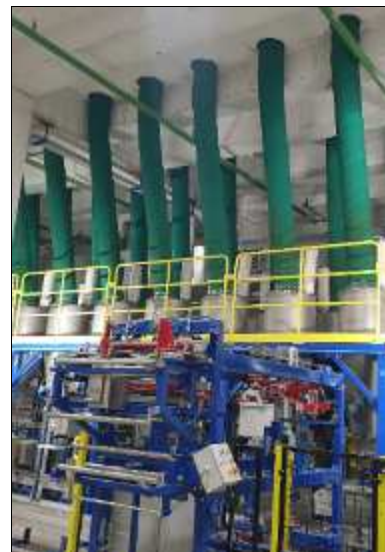
Рисунок 3.4 – Герметичный трубопровод с 3 этажа со шкафов загрузки МХ на весы–дозаторы 2 этаж
