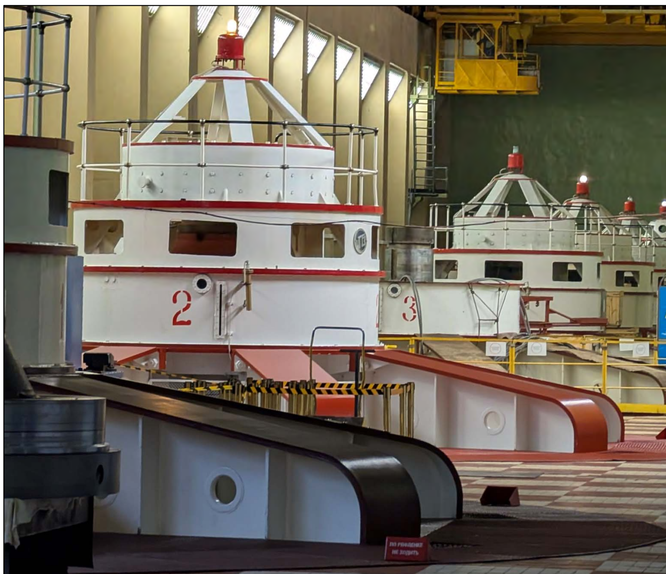
Рисунок 2.1. Помещение машинного зала Бухтарминской ГЭС
