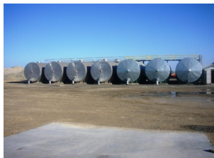
Резервуары хранения воды
