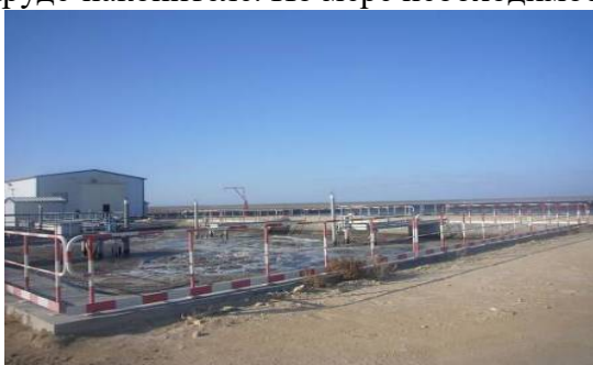
Очистные сооружения (общий вид)
