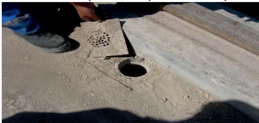
Фото 3.4. Дождепремный колодец с решеткой
