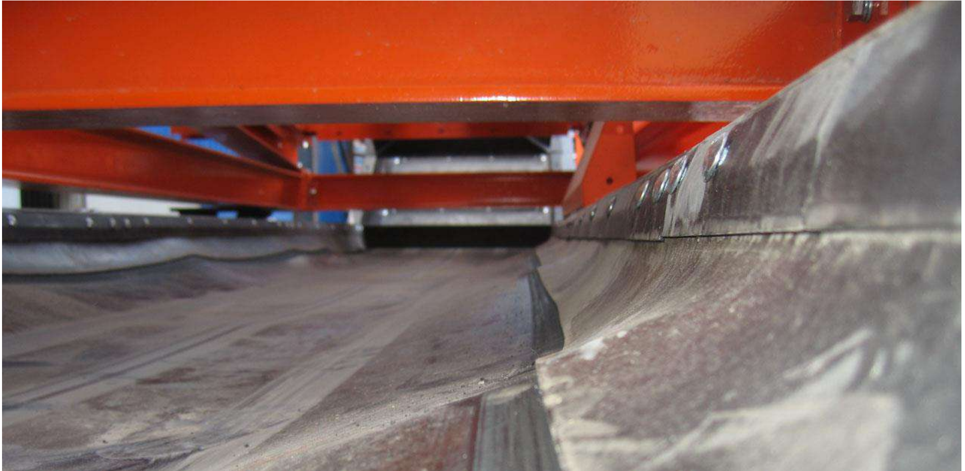
Рис. 8. Уплотнение по краям ленты ленточного конвейера
