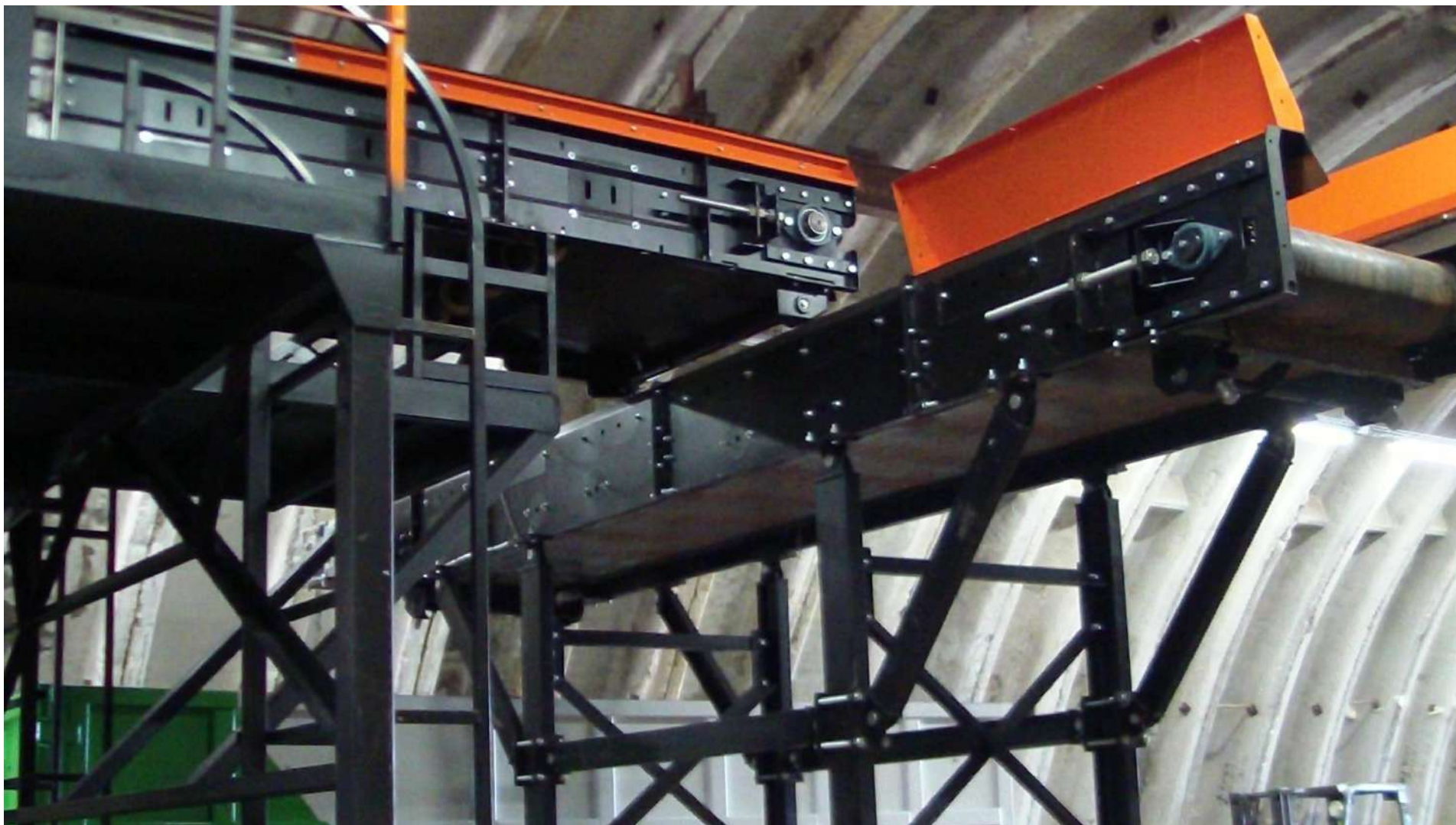
Рис.10. Очистные устройства ленточных конвейеров под натяжным барабаном.
