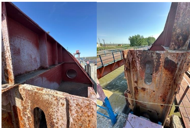
Рисунок 17 – Неудовлетворительное состояние затворов
