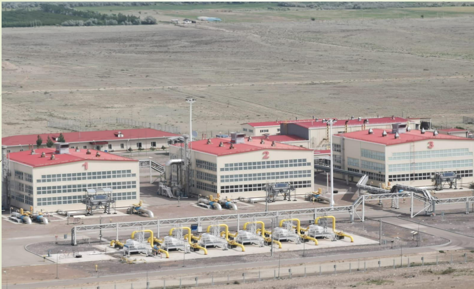
➤ №1 өнеркәсіп алаңы: Компрессорлық станция
