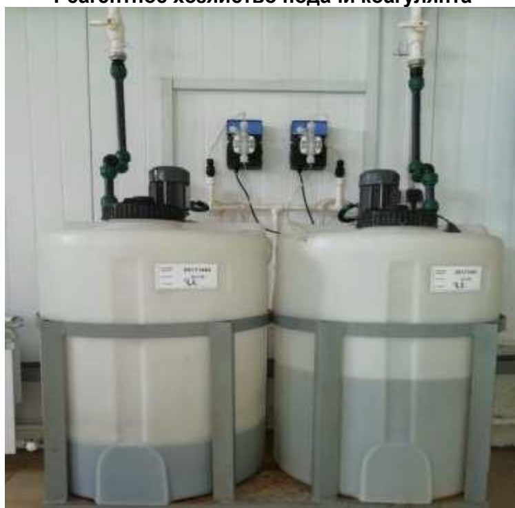
Реагентное хозяйство подачи коагулянта
