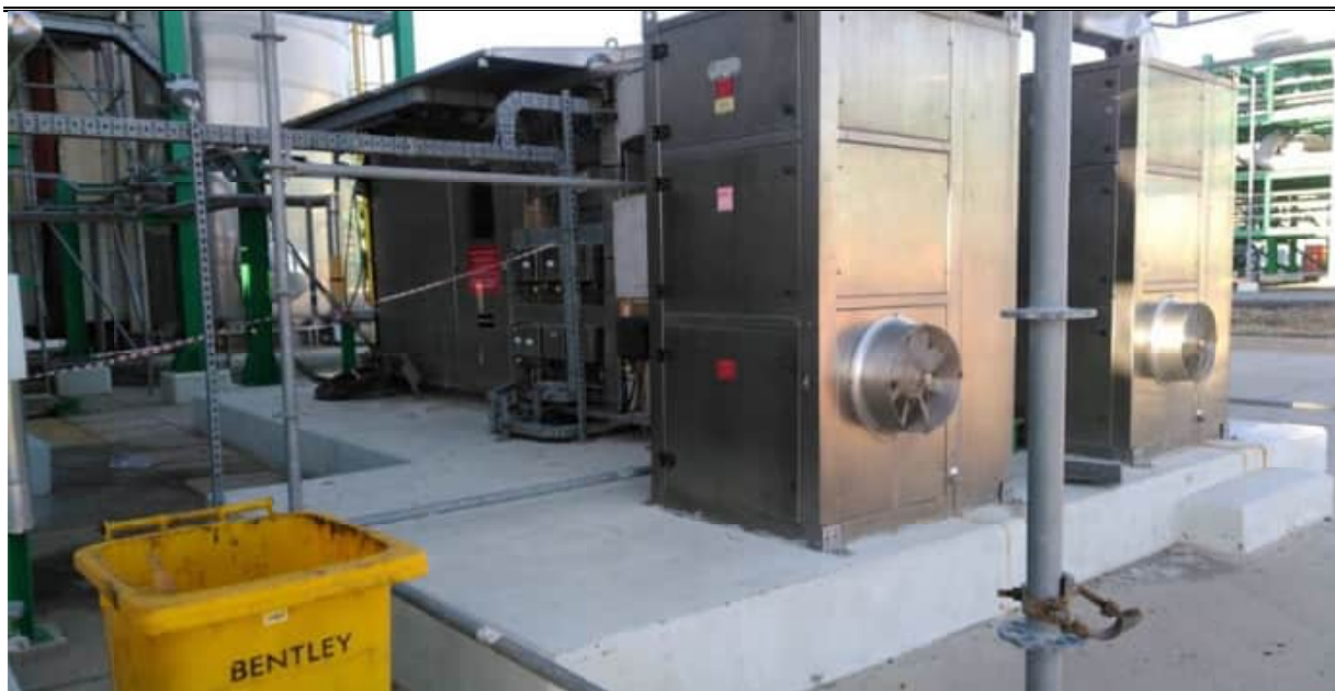
Рисунок 1.4.1.-4. Существующий блок-бокс анализатора А1-3321-JA-002 вид сзади и сбоку
