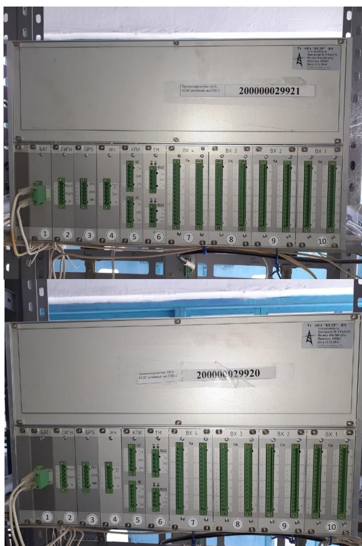
Рис. 4.2.4. Фото ВЧ-передатчиков АКА «КЕДР» на панелях релейного щита ГПП-2
