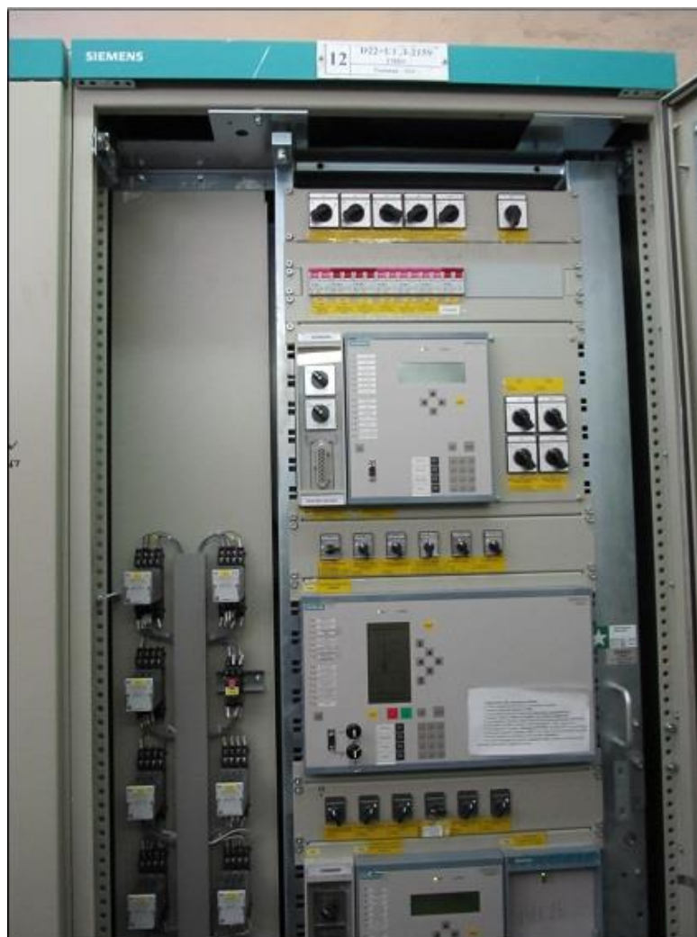
Рис. 4.1.1. Внешний вид шкафа РЗА ВЛ 220 кВ Л-2159 на ПС 500 кВ Жамбыл
