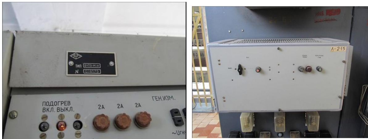
Рис. 4.2.1. Фото устройств ВЧ-связи по ВЛ 220 кВ на ГПП-1 НДФЗ
