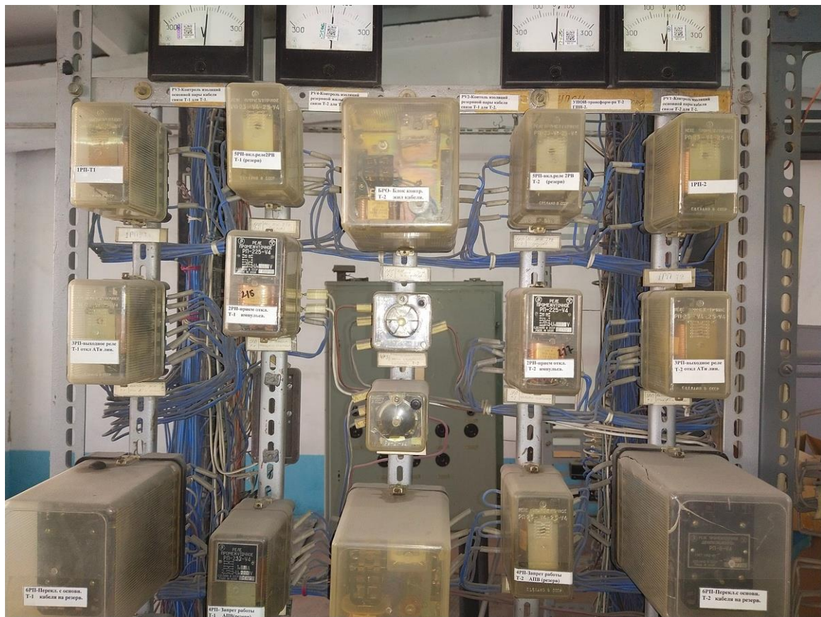
Рис. 4.2.2. Фото фрагмента панели 63Р приема отключающего импульса на ГПП-1
