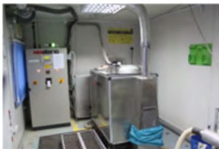
Фото 16 Установка для обезвреживания медицинских отходов – «Ньюстер 10»
