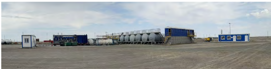
Фото 1 Мобильная установка по переработке нефтешлама
