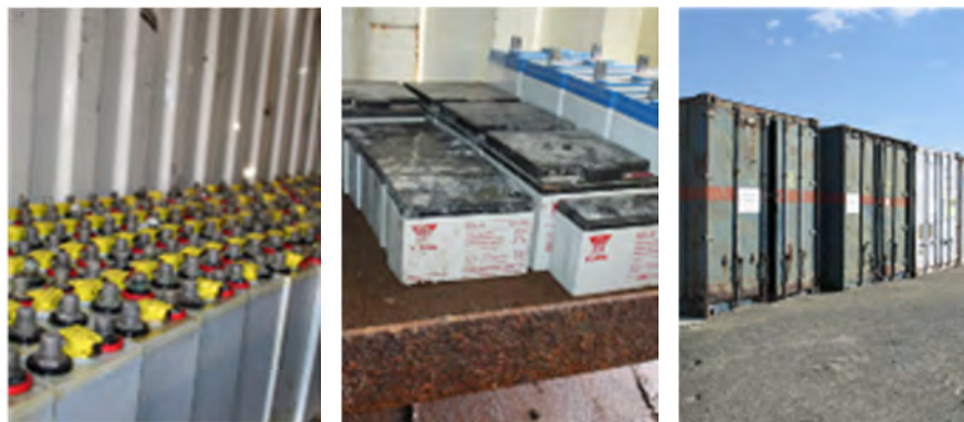
Фото 20 Площадка временного накопления для отработанных аккумуляторов на ТЭЦ
