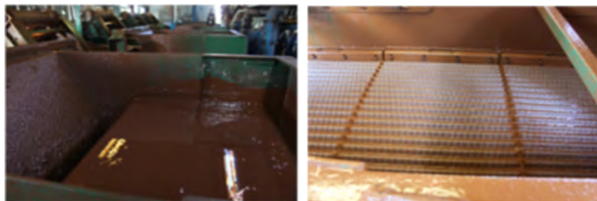
Фото 18 Установка очистки бурового раствора
