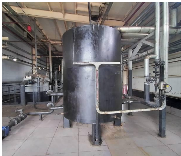
Фото 16. Резервуар сбора шлама V-5м 3 (танк 6)
