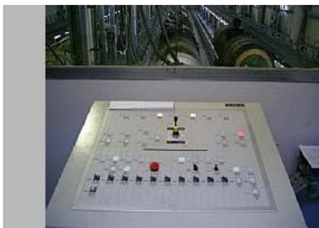
Фото 9. Пульт управления в автоматическом режиме компаний VL International Projects Ltd
