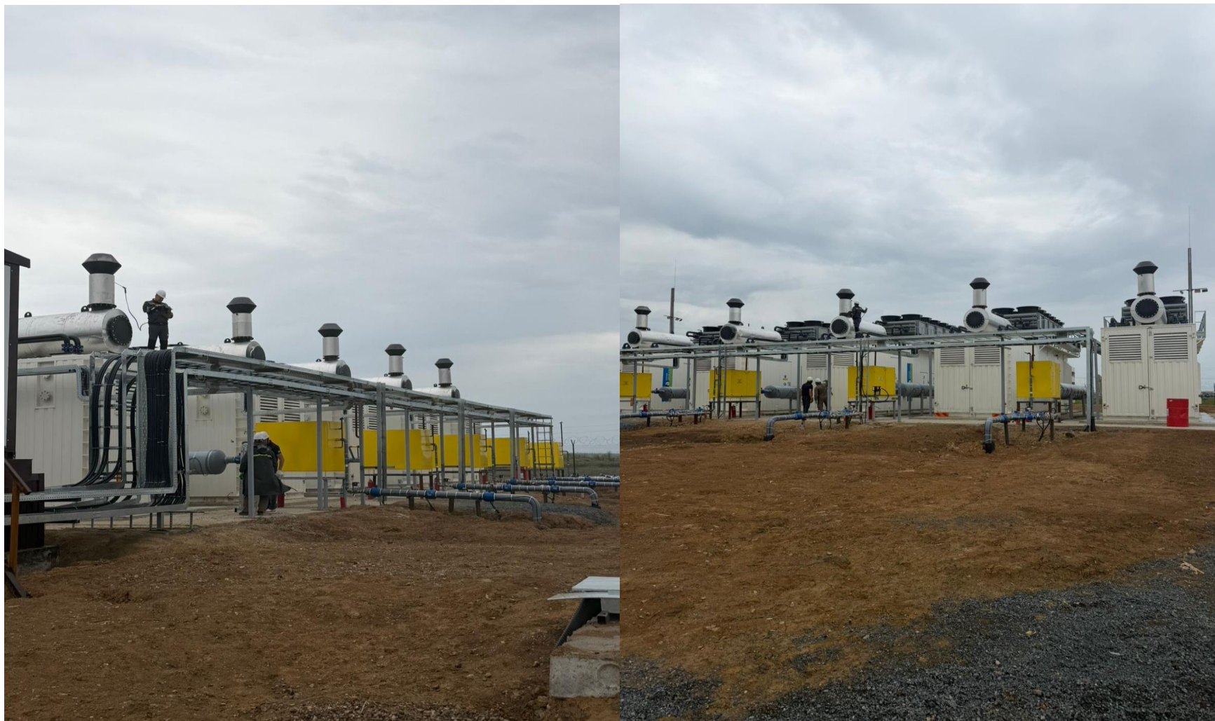
Рис.4. Газопоршневые электро станции
