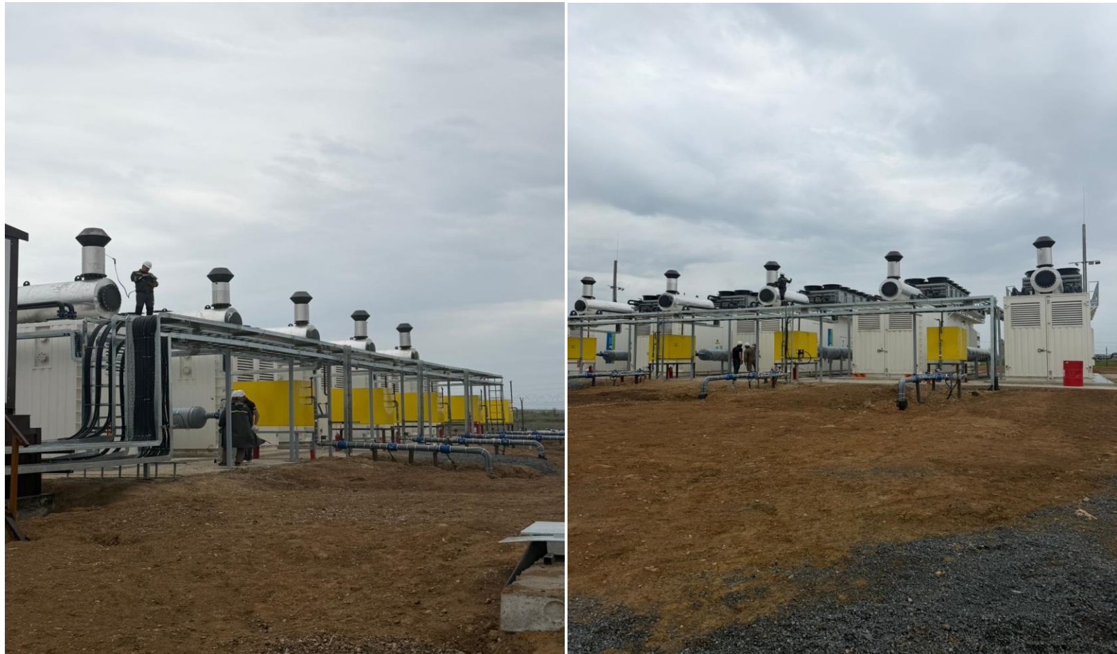
Рис.4. Газопоршневые электро станции
