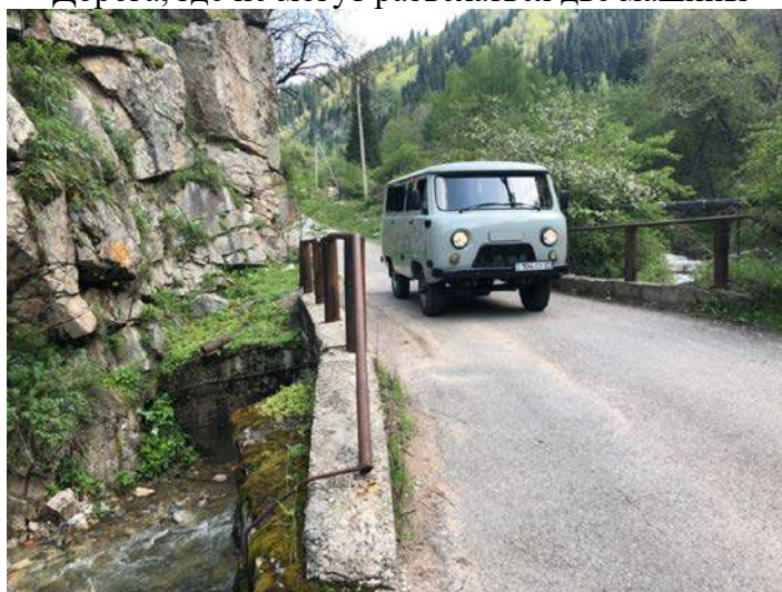
Аварийные мосты, которые могут разрушиться и привести к гибели людей
