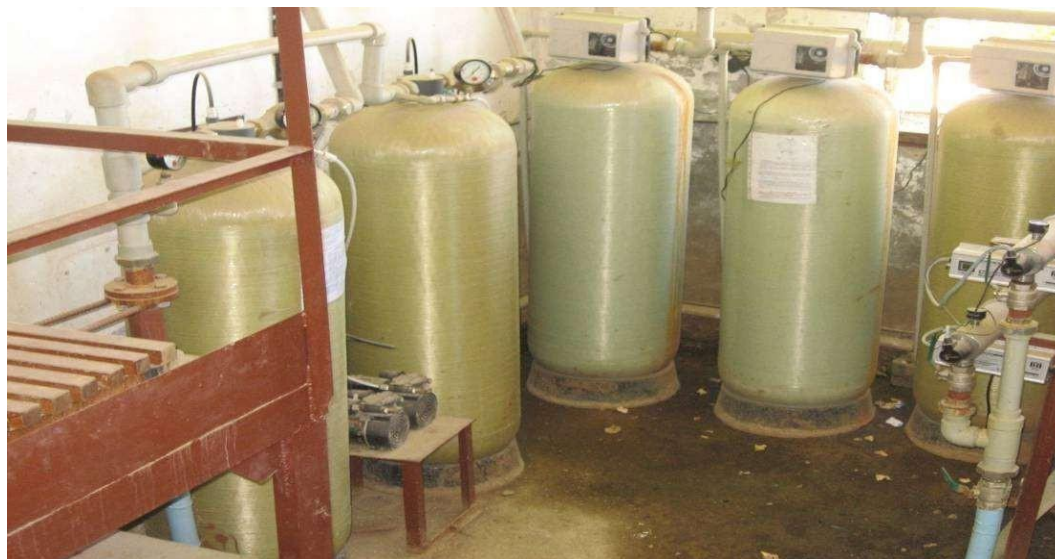
Рисунок 24. Линия очистки воды.
