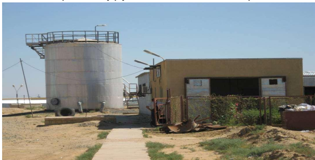
Рисунок 23. Резервуар для запаса воды на хоз-бытовые нужды
