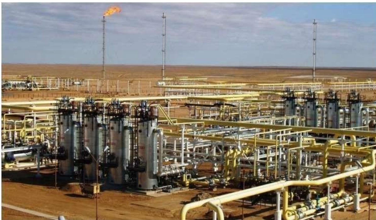
Рисунок 8. Установка осушки газа (УОГ)
