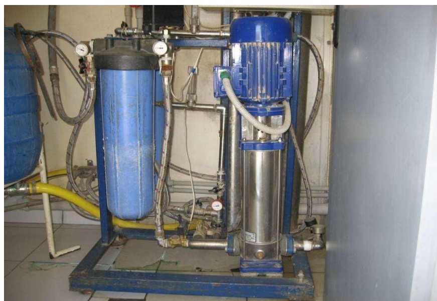
Рисунок 26. Установка очистки воды «Ручеек 2С/30-02-07»
