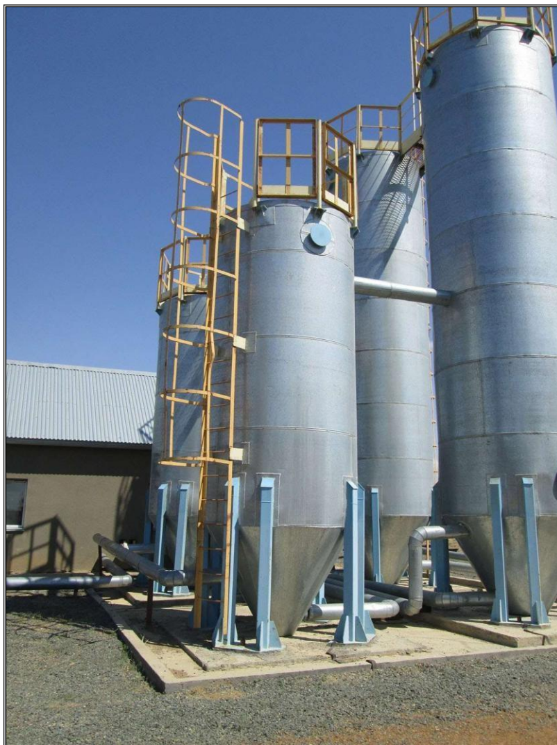
Рисунок 32. Очистные сооружения биологической очистки производительностью 200 м³/сут.
