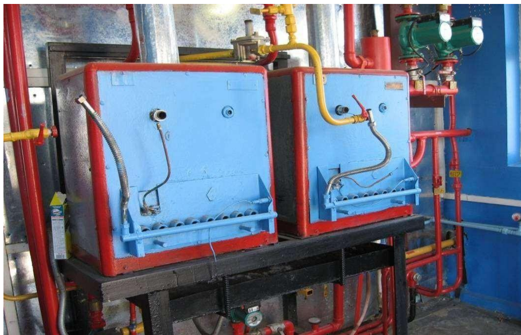
Рисунок 12. Котельная с водонагревателями на ГСП
