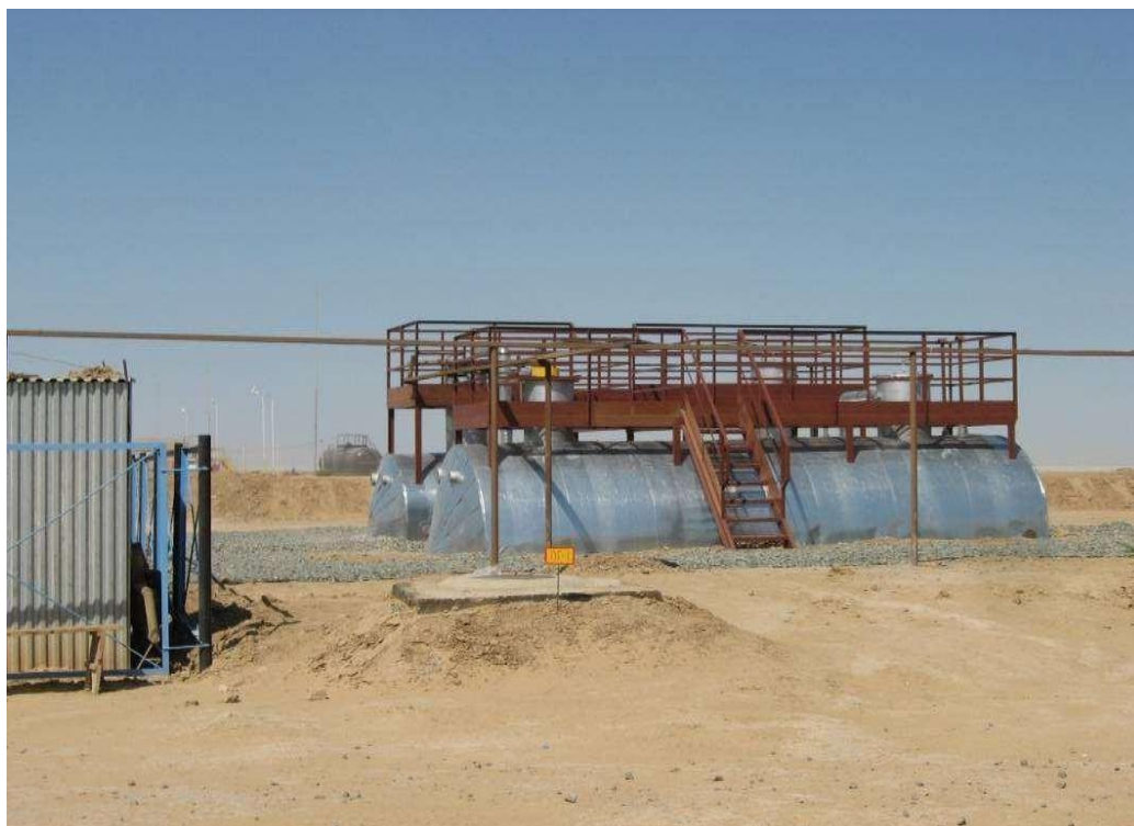
Рисунок 11. Резервуары запаса воды на пожаротушение на ГСП
