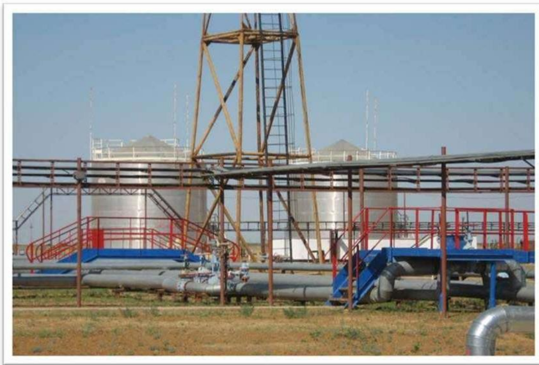
Фото 3. Резервуары хранения воды на пожаротушение
