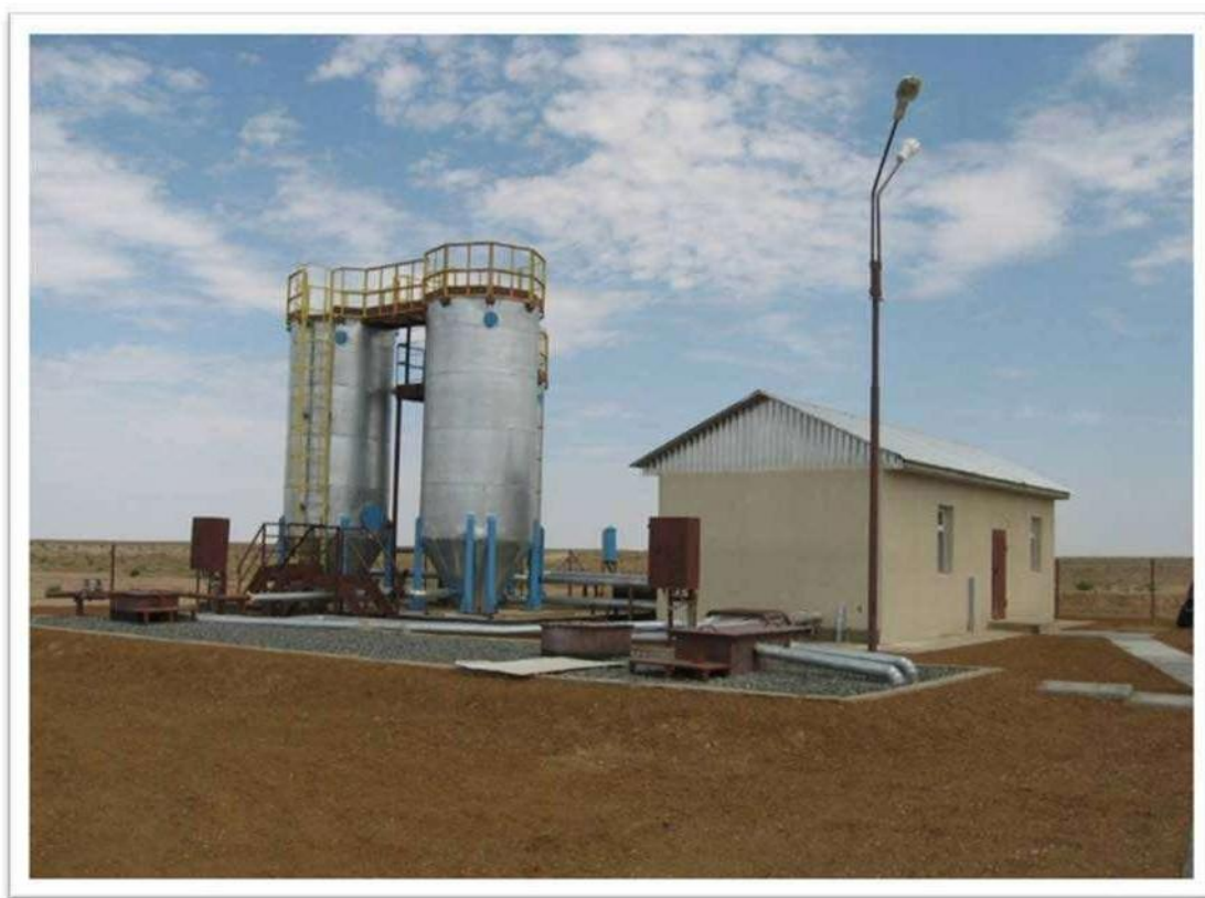
Фото 12. Очистные сооружения биологической очистки
