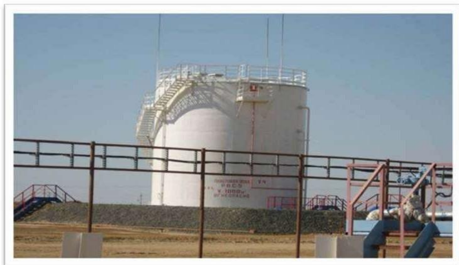
Фото 9. ЦППН. Резервуар пластовой воды объемом 1000 м 3
