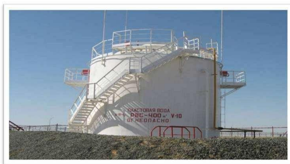
Фото 10. ЦППН. Резервуар пластовой воды объемом 400 м 3
