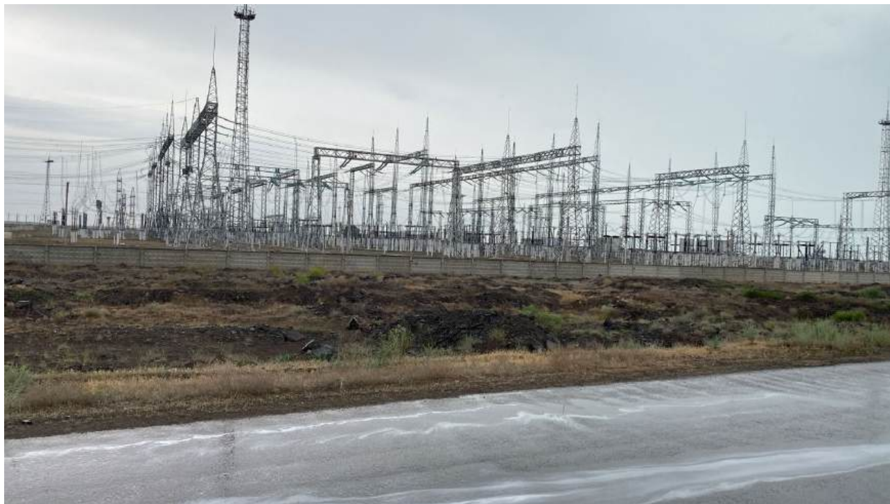
Зона обследования ПС Улкен конец ЛЭП
