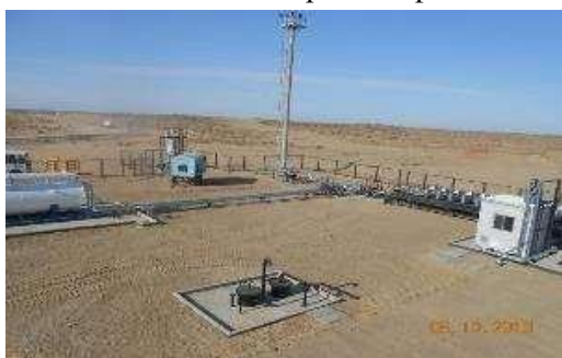
Рис.2.5 - Замерная установка ЗУ
