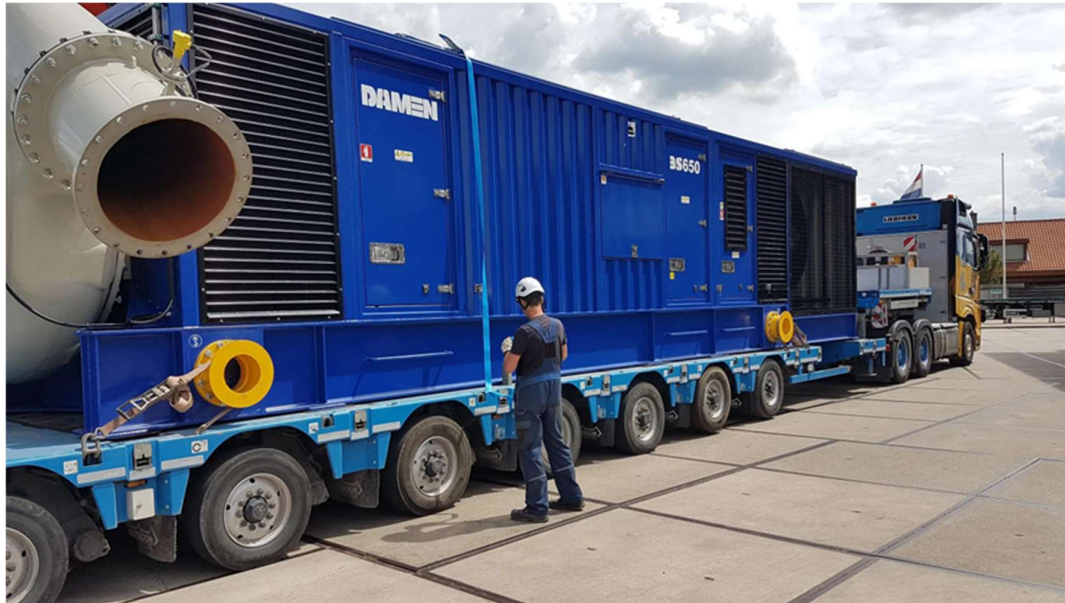
Рисунок 5.2 Подпорная насосная станция
