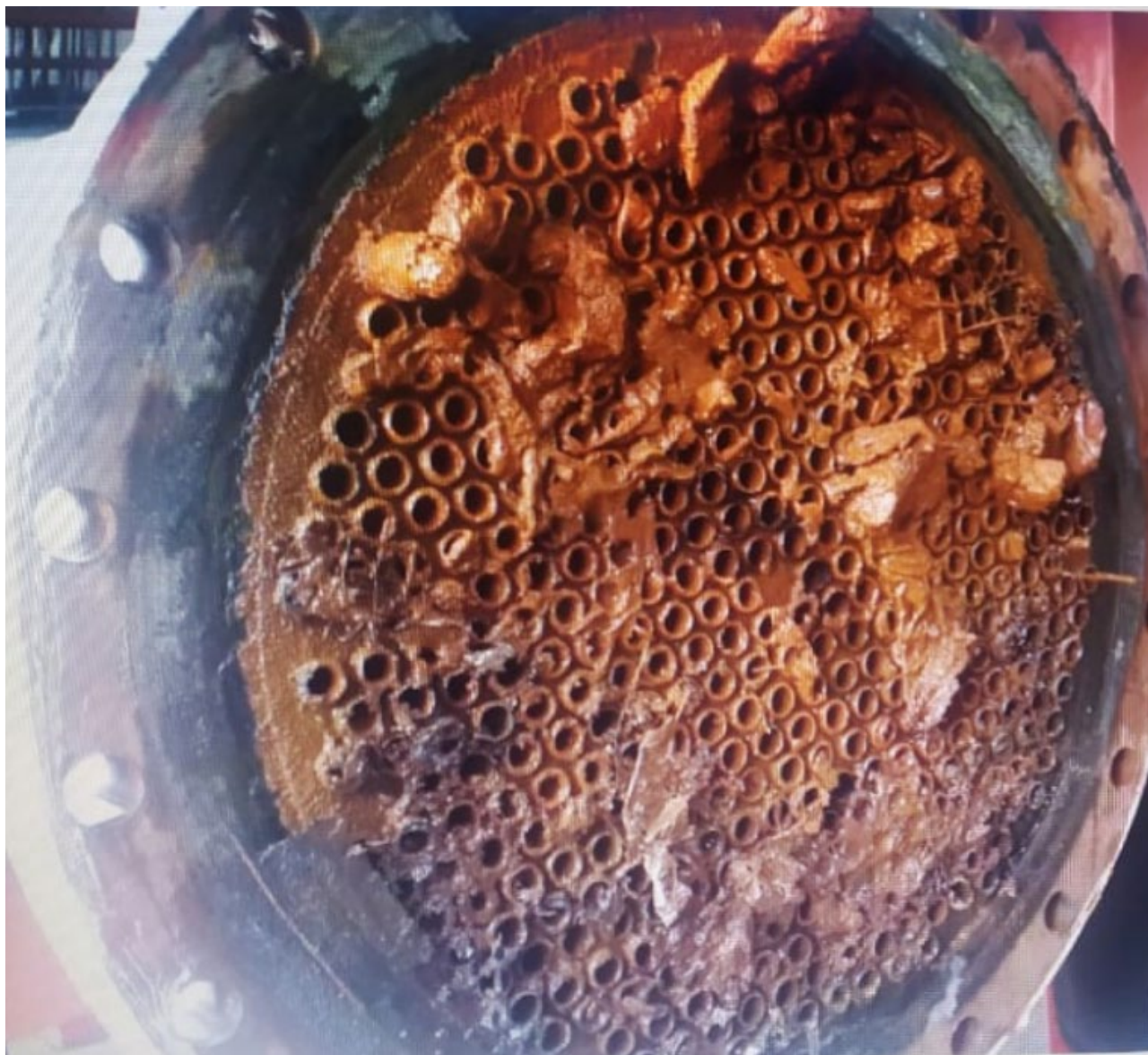
Рисунок 7 – состояние трубной решетки теплообменника.
