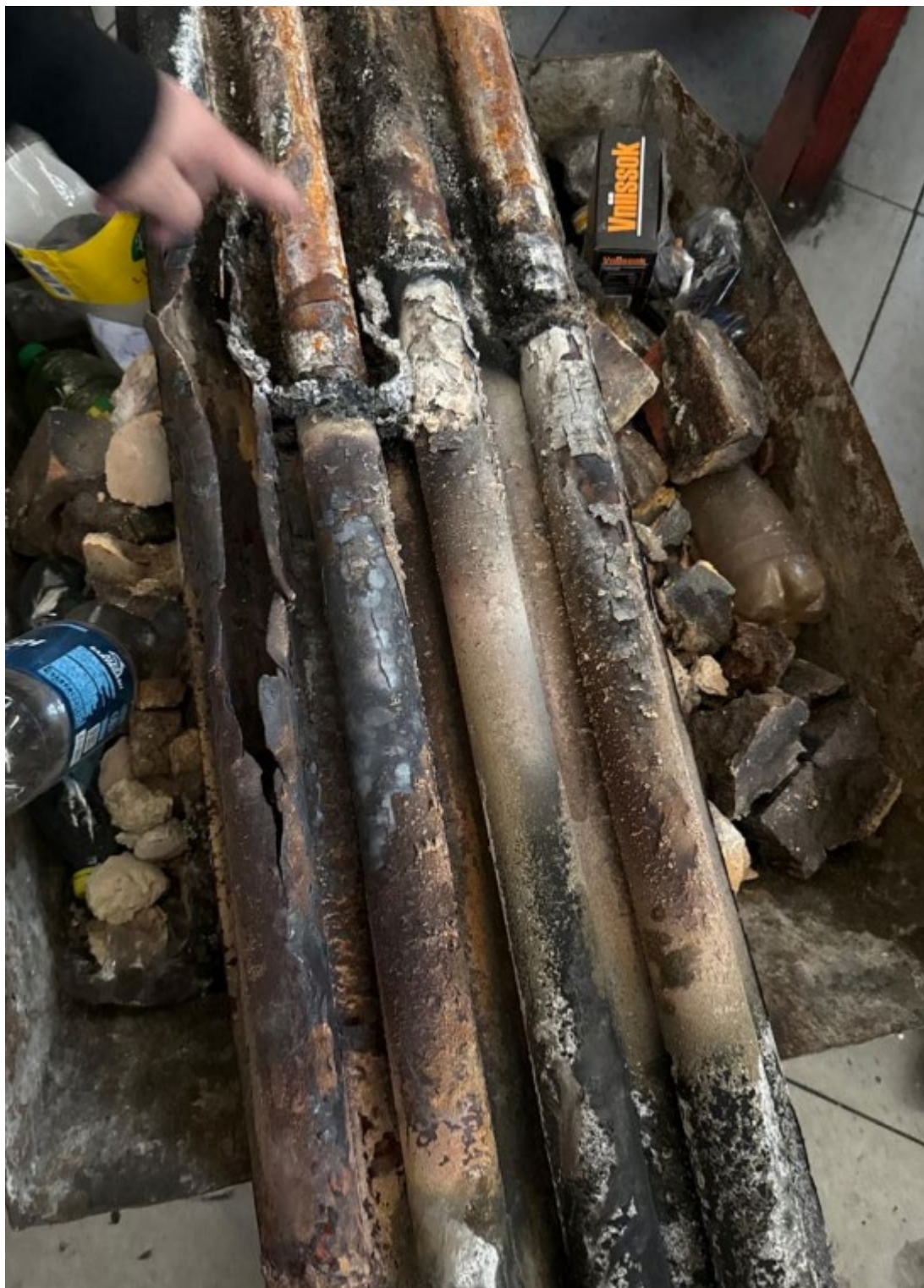
Рисунок 6 – трубчатая часть парового котла.
