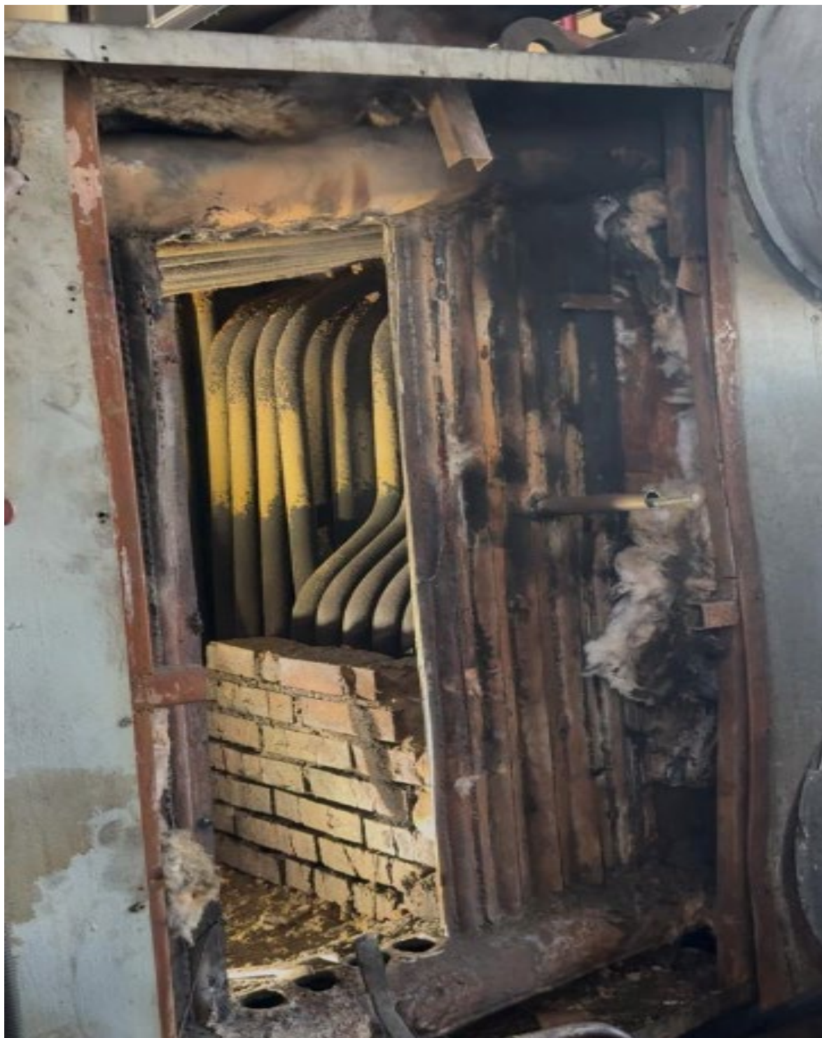
Рисунок 5 – состояние парового котла.
