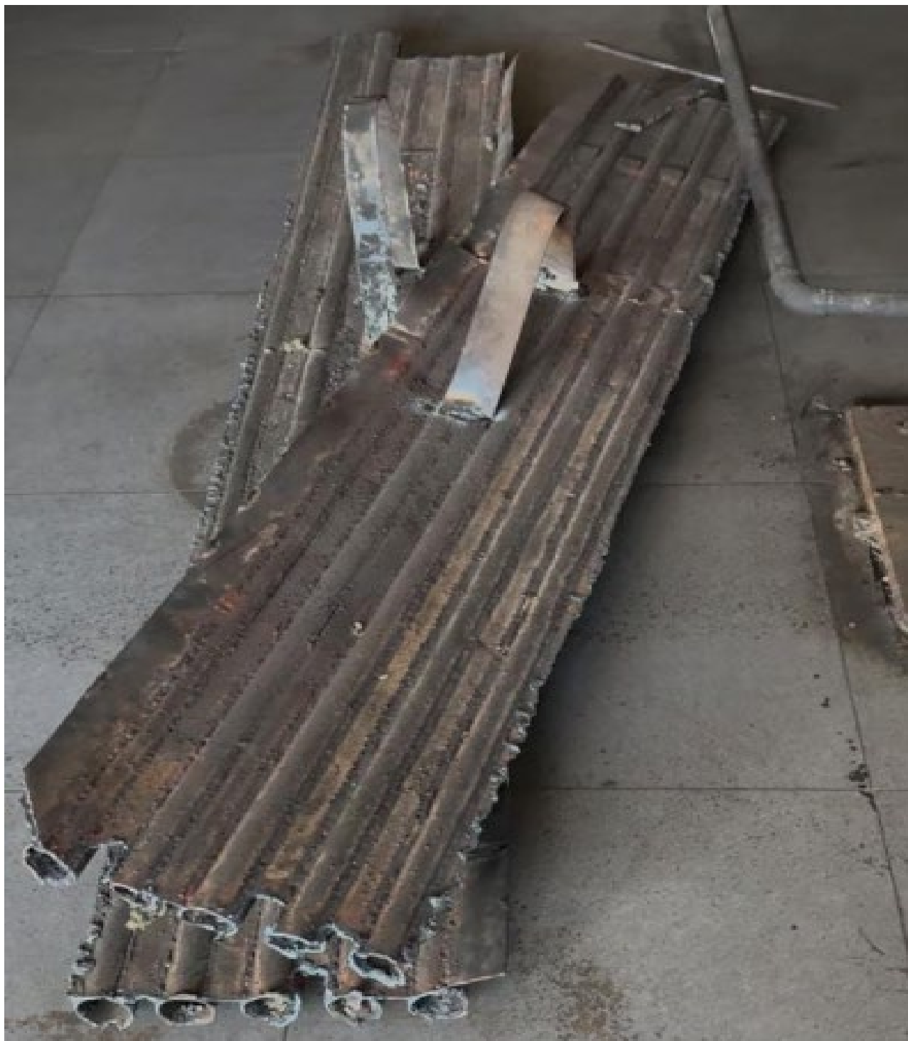
Рисунок 9 – состояние водогрейного котла №3.
