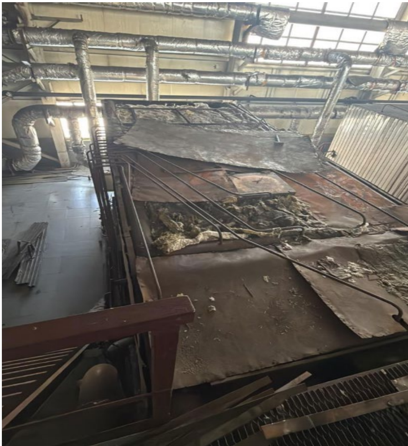
Рисунок 8 – состояние водогрейного котла №3.
