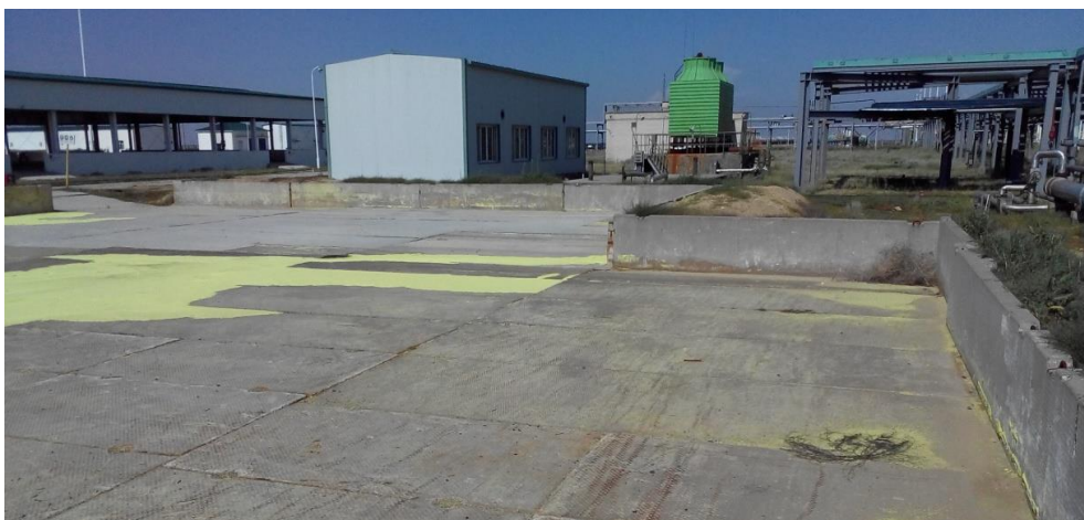
Площадка серной карты в Цехе хранения и транспортировки товарной продукции /ЦХ и ТТП/.
