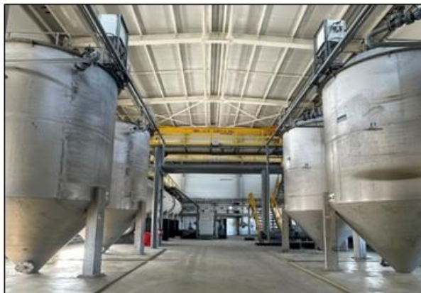
Станция фильтровальных стоков
