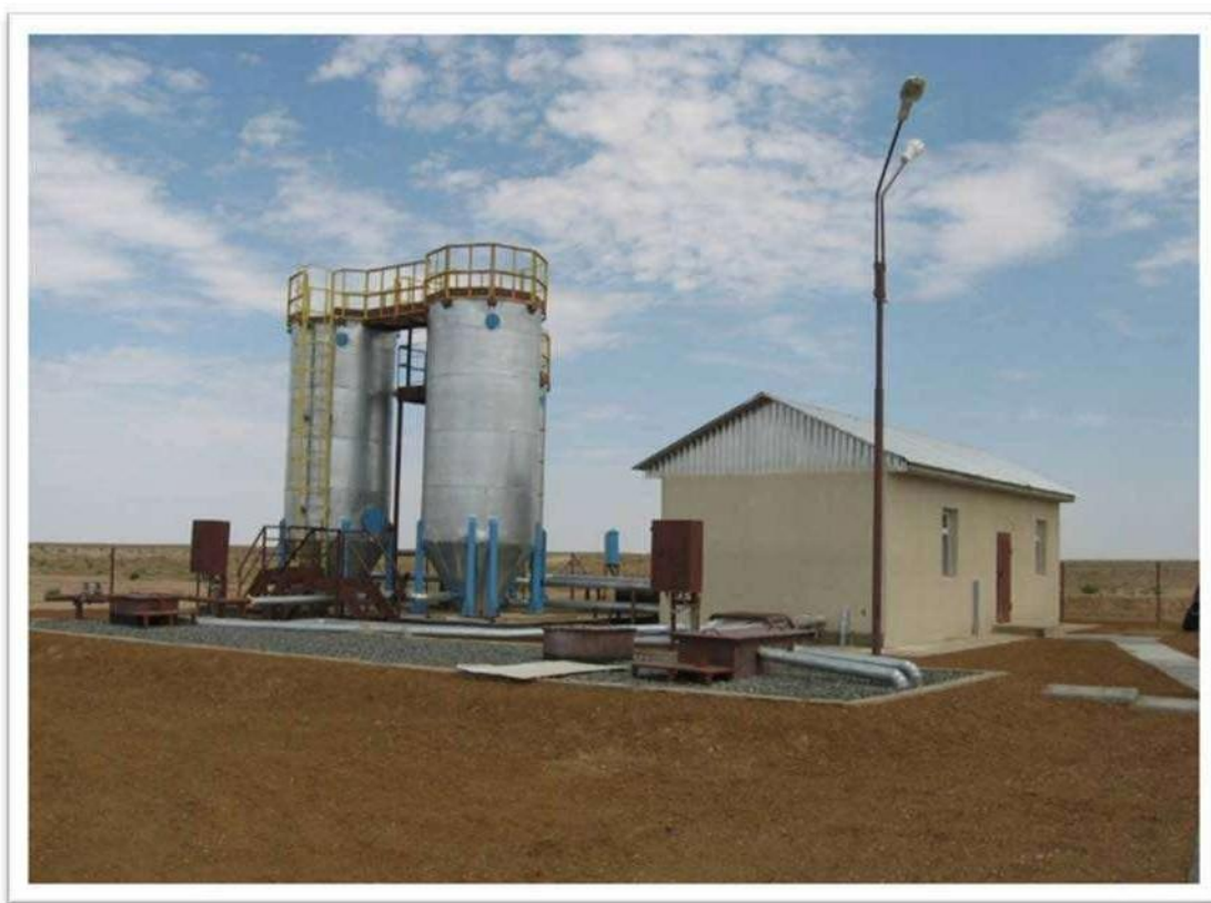
Фото 12. Очистные сооружения биологической очистки
