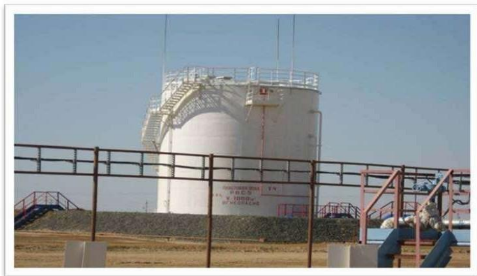
Фото 9. ЦППН. Резервуар пластовой воды объемом 1000 м 3
