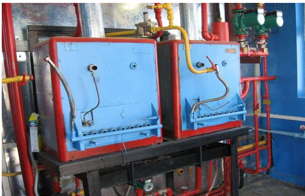
Рисунок 12. Котельная с водонагревателями на ГСП
