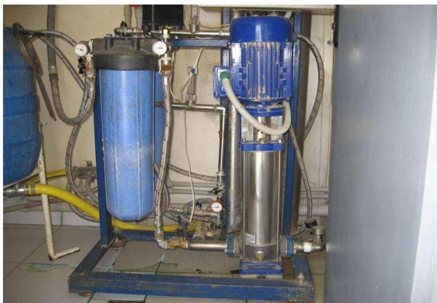
Рисунок 26. Установка очистки воды «Ручеек 2С/30-02-07»
