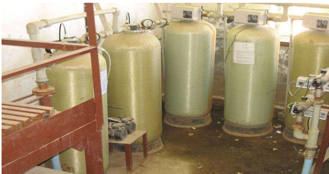
Рисунок 24. Линия очистки воды.
