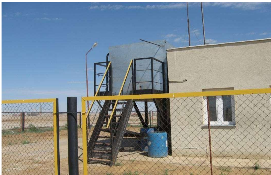
Рисунок 13. Резервуар запаса воды на хоз-бытовые нужды на АБК
