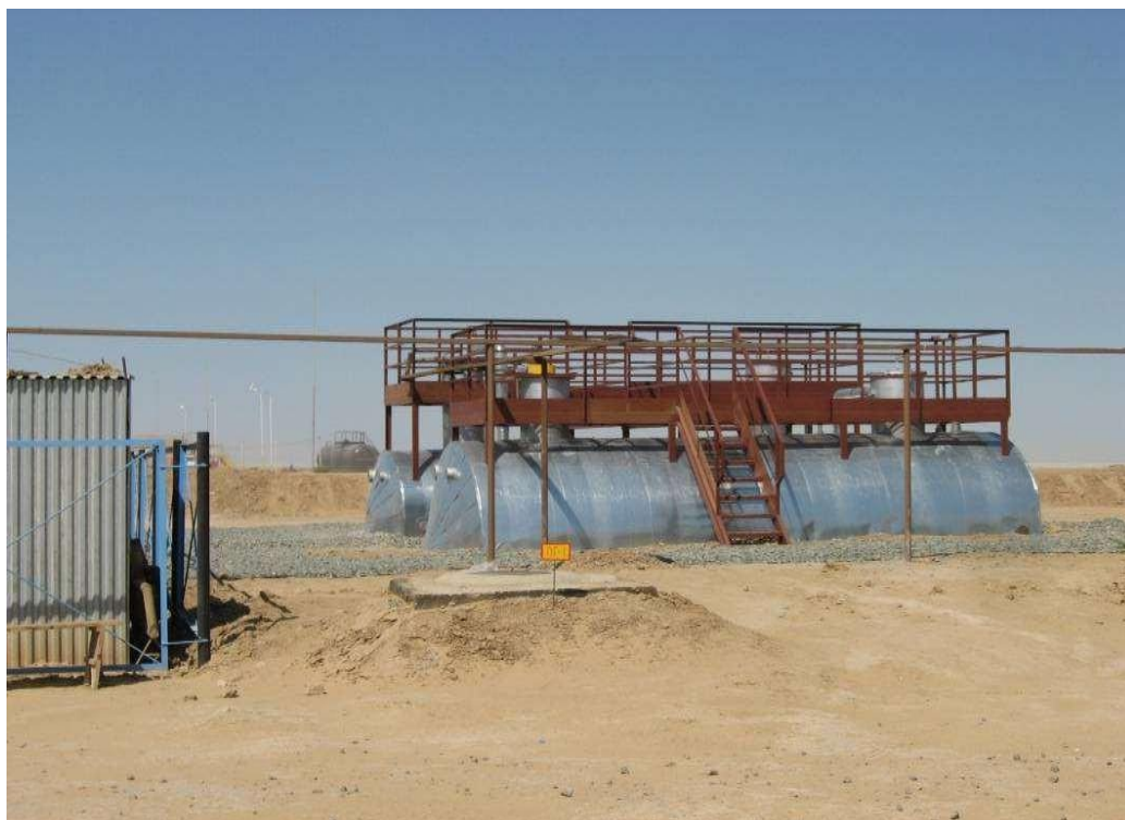
Рисунок 11. Резервуары запаса воды на пожаротушение на ГСП
