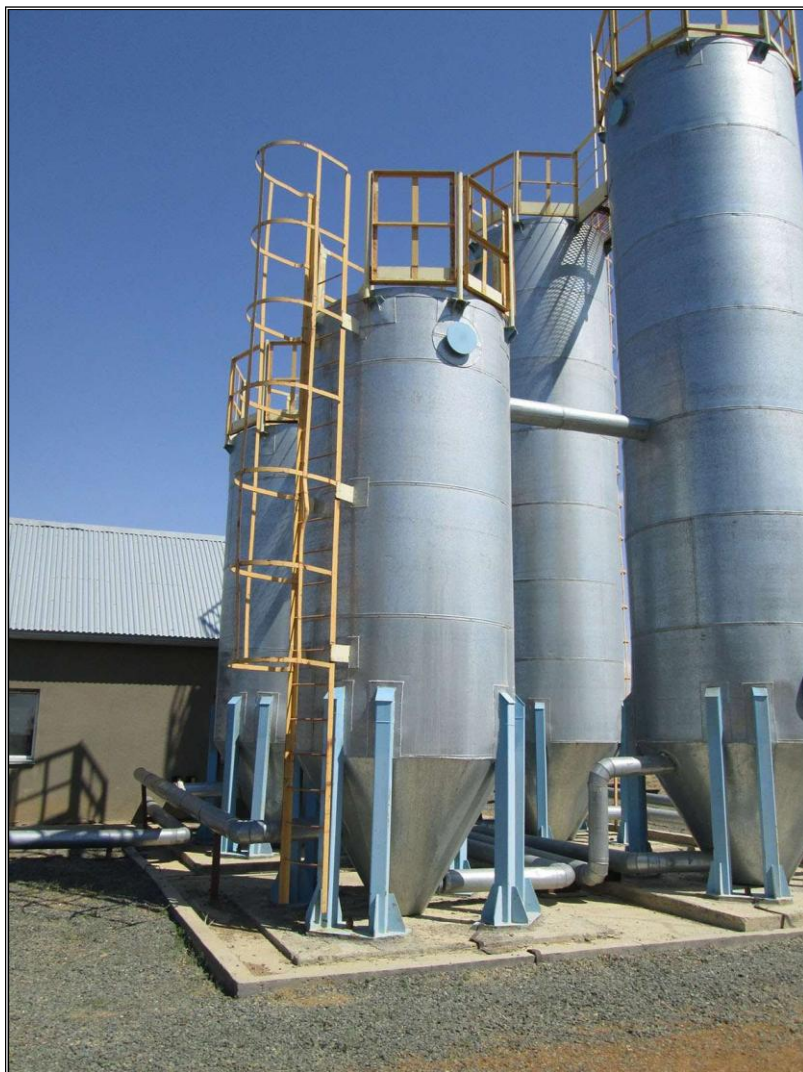
Рисунок 32. Очистные сооружения биологической очистки производительностью 200 м 3 /сут.
