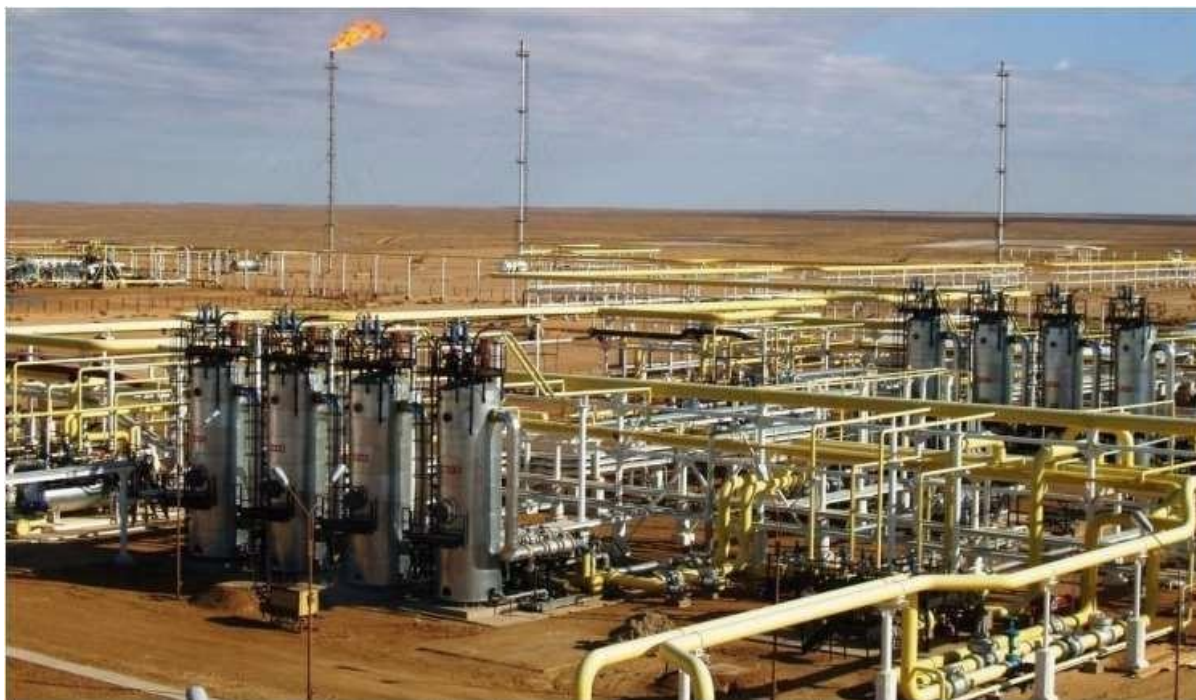
Рисунок 8. Установка осушки газа (УОГ)
