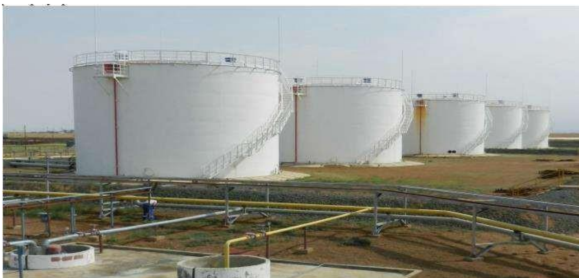
Рисунок 3 - Резервуарный парк для хранения конденсата
