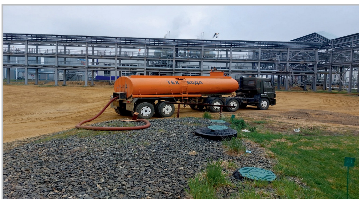
Фото 2. Слив бытовых сточных вод в приемные колодцы перед Установкой ЛОС-Р-35-С (Титул 33)
